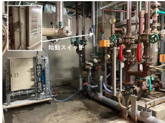
図 13 オゾン供給装置設置状況 (RUN3)
