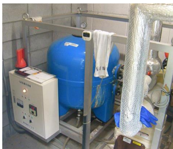
図 2 循環ろ過器 (RUN 1、RUN 2)
