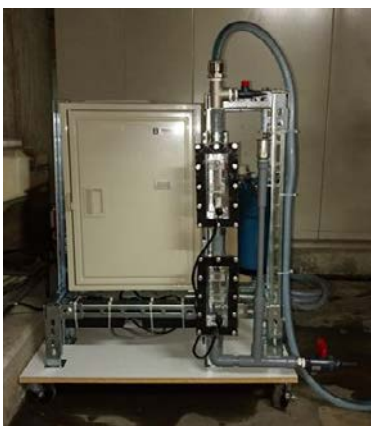
図3 オゾン供給装置 （ろ過器のオゾン消毒）
