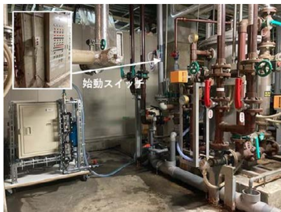
図4 オゾン供給装置設置状況 （ろ過器のオゾン消毒）
