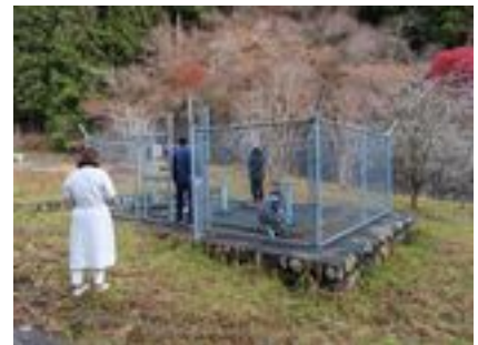
写真 7 牧野浄水場配水区域 第 2 減圧水槽
