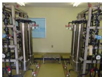
写真 4 猪古里浄水場膜ろ過施設
