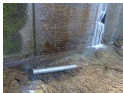
写真 5 ストレーナ付き集水管
