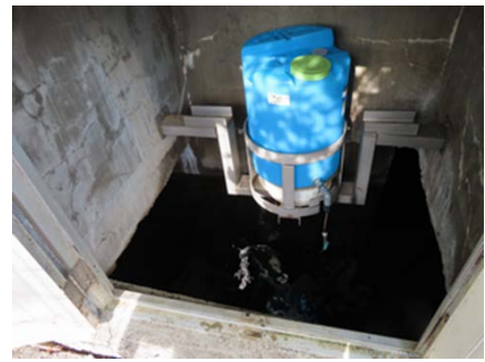
写真2 大和合東村飲料水供給施設 配水池内の塩素注入装置
