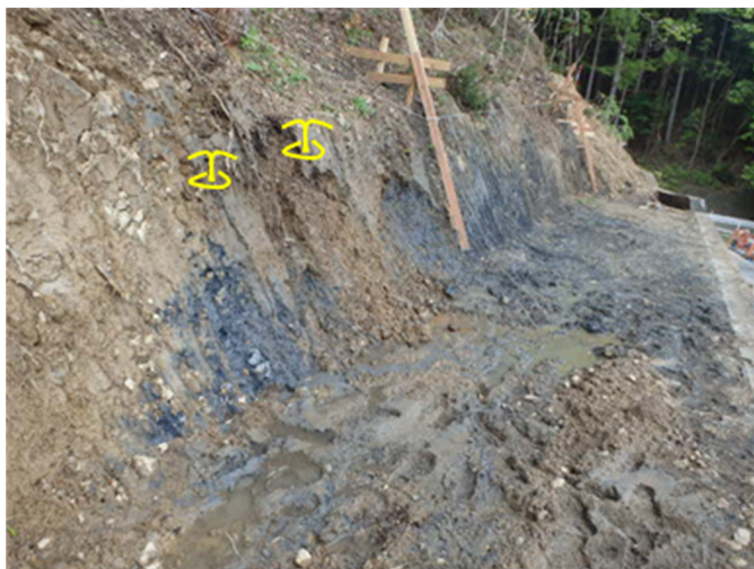
写真-3 区間2 測点 32.00 付近の湧水と小崩壊と粘土化した岩盤
