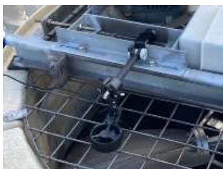
A) 冷却塔への風速計設置例
