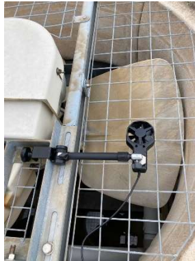
風速計設置（埼玉県）
