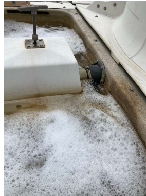
上部散水槽（埼玉県）
