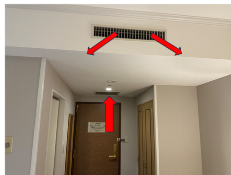
図2 客室FCU吹出口と吸込み口
