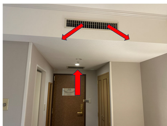
図2 客室FCU吹出口と吸込み口
