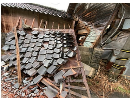
＜写真1＞能登半島地震により被災した地域の状況
