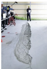
メタンガス引火による爆発事故があったトイレの建設現場（2日午後、大阪市此花区）＝共同通信撮影
