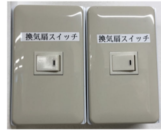
写真1. 1. 4-1 換気扇スイッチ
