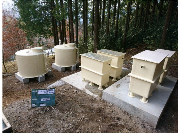
図 35 沈砂池 1 基，粗ろ過 1 基，緩速ろ過 2 基 寒冷地仕様断熱 FRP 製配水池 2 トン 2 基 2 世帯，6 人 1.8m 3 /日（別府市 T 地区）
