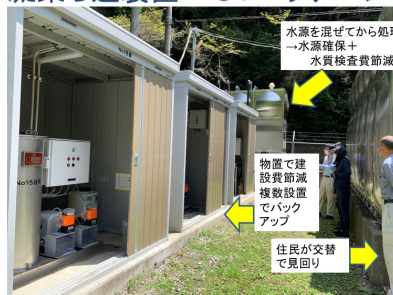
写真6 水源を統合し処理装置を並列設置した施設
