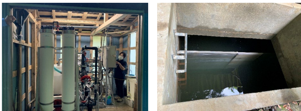
写真7 UF膜処理装置と住民制作の整流壁
