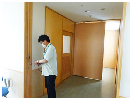
写真3 障害者支援施設のユニットの中に設けた可動間仕切り
