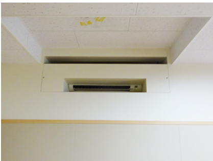
写真11 視覚的刺激にならないよう、壁に埋め込んだエアコン
