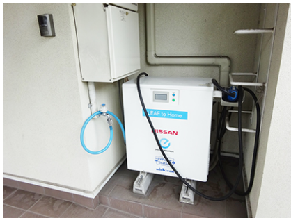
写真 23 電気自動車のバッテリーを利用した蓄電装置
