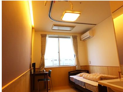
写真14 ベッドと車椅子の移乗のために設置した天井走行式リフト
