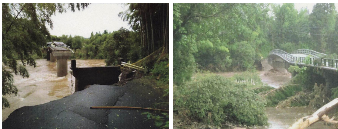
写真-1. 下泊里橋 被災状況（玖珠町役場提供）
