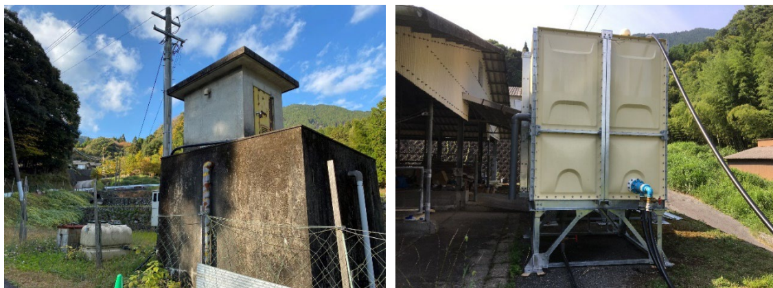
写真-3. 個人所有の取水設備と仮設タンク
