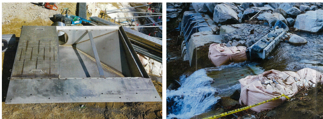
写真-9 鷺ノ平取水口の仮復旧状況（丸森町役場提供 撮影日不明）
