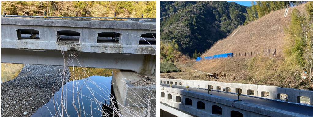
写真-12. 更新を控える宮嶋橋（著者ら撮影 令和5年1月30日現地視察時）
