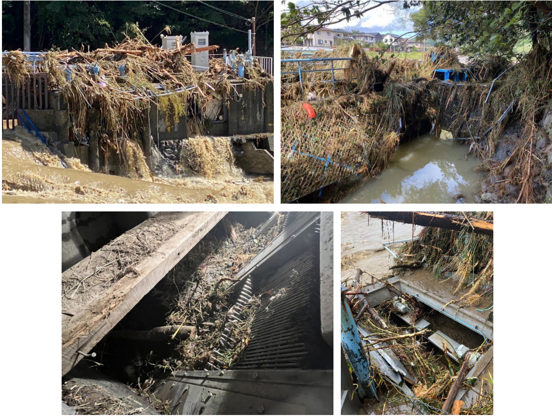
写真-3. 被災時の承元寺取水口
