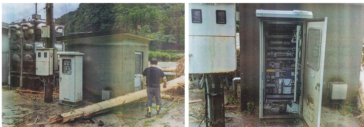
写真-3. 浸水被害にあったポンプ設備（日田市上下水道局提供 撮影日不明）
