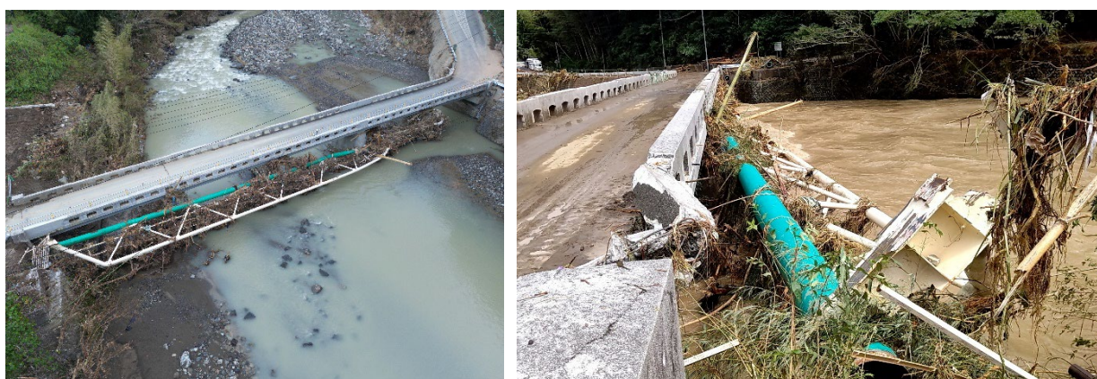
写真-1. 被災時の宮島水管橋（静岡市上下水道局提供 令和4年9月24日撮影）
