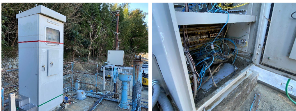
写真-15. 被害を受けた制御盤（著者ら撮影 令和5年1月30日現地視察時）
