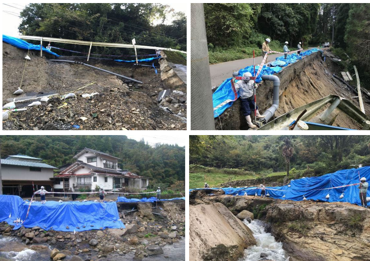
写真-1. 管路被害状況（九重町役場提供 撮影日不明）
