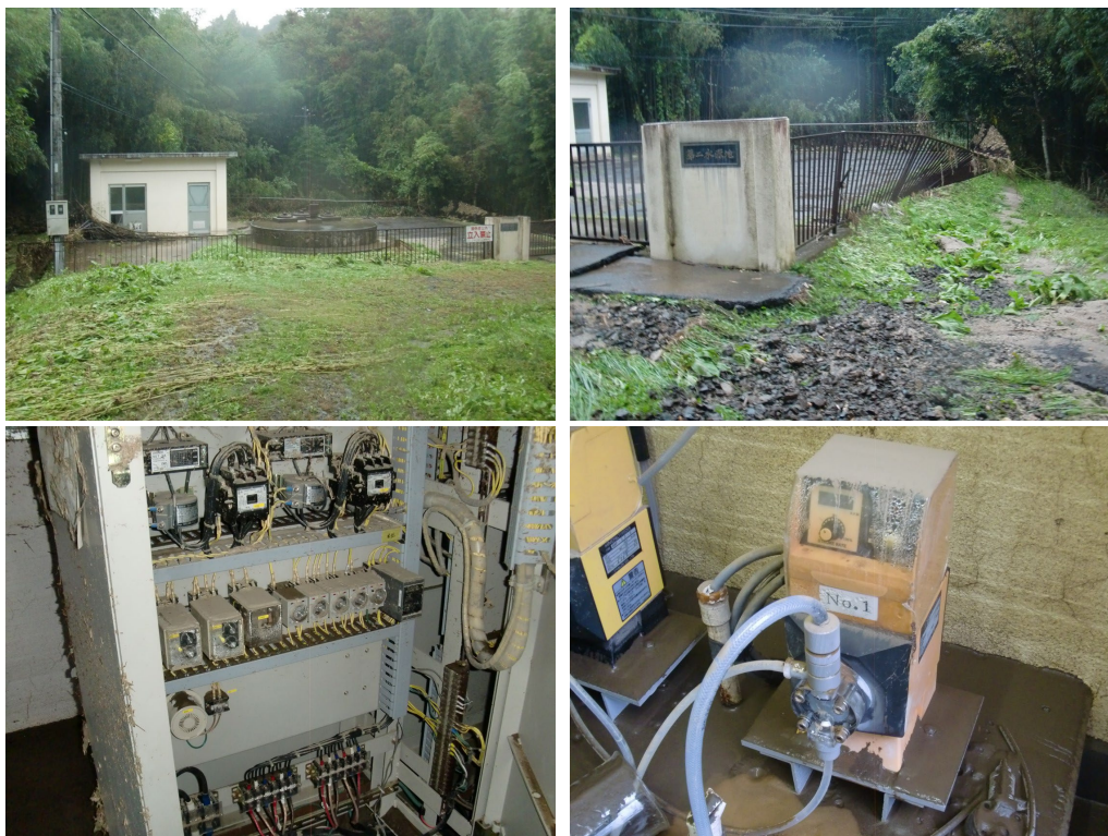
写真-4. 岩代第2水源 被災状況（二本松市役所提供，撮影日不明）
