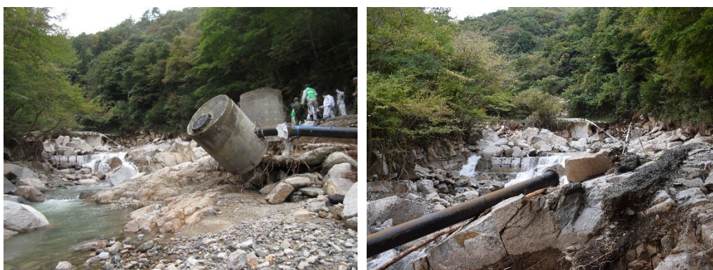
写真-1. 鷺ノ平取水口 被災状況（仙台市水道局提供，令和元年 10 月 21 日撮影）
