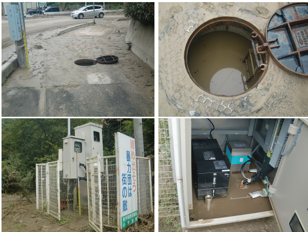
写真-8. 圧力調整弁 被災状況（二本松市役所提供、撮影日不明）
