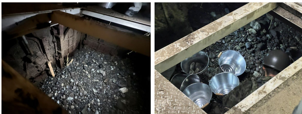
写真-8. 取水施設内部に堆積した土砂（静岡市上下水道局提供 令和4年9月27日撮影）
