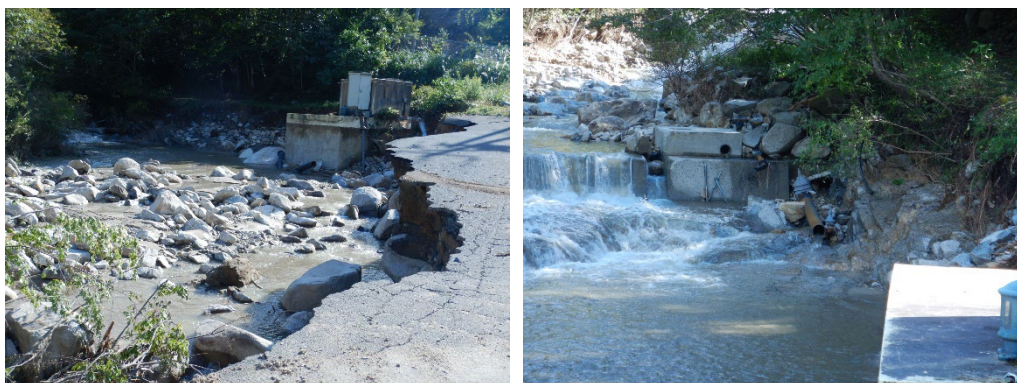
写真-2. 黒佐野取水口 被災状況（仙台市水道局提供，令和元年 10 月 15 日撮影）
