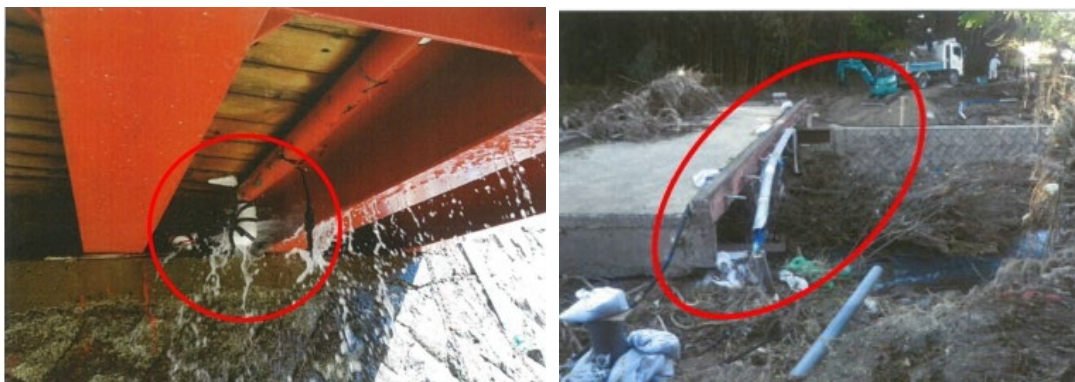
写真-2. 河川水流による給水管破損（郡山市上下水道局提供，図-1 中の 3 および 4）
