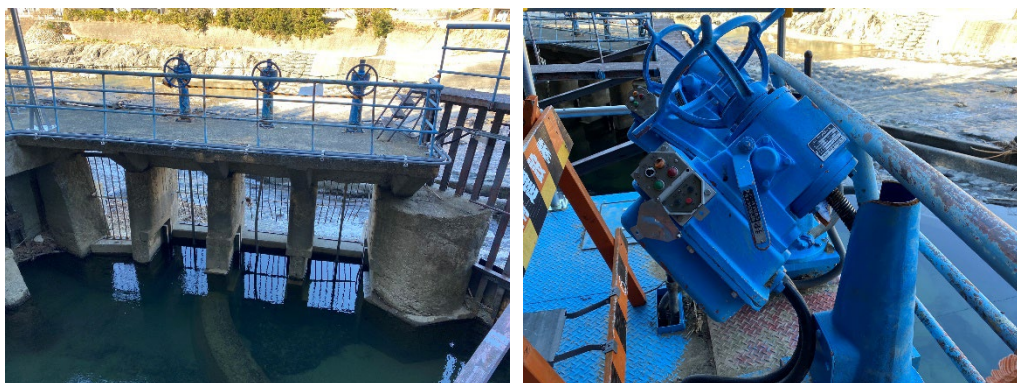
写真-16. 本復旧未着手の設備（著者ら撮影 令和5年1月30日現地視察時）
