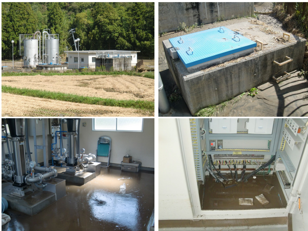
写真-6. 岩代第4水源 被災状況（二本松市役所提供，撮影日不明）
