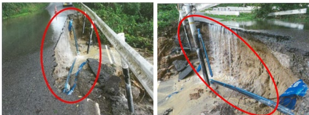
写真-1. 道路崩壊に伴う配水管破損（郡山市上下水道局提供、図-1 中の 2）
