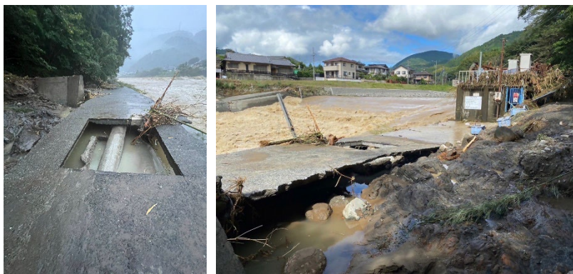
写真-6. 承元寺取水口への経路における被災状況（静岡市上下水道局提供 令和4年9月24日撮影）
