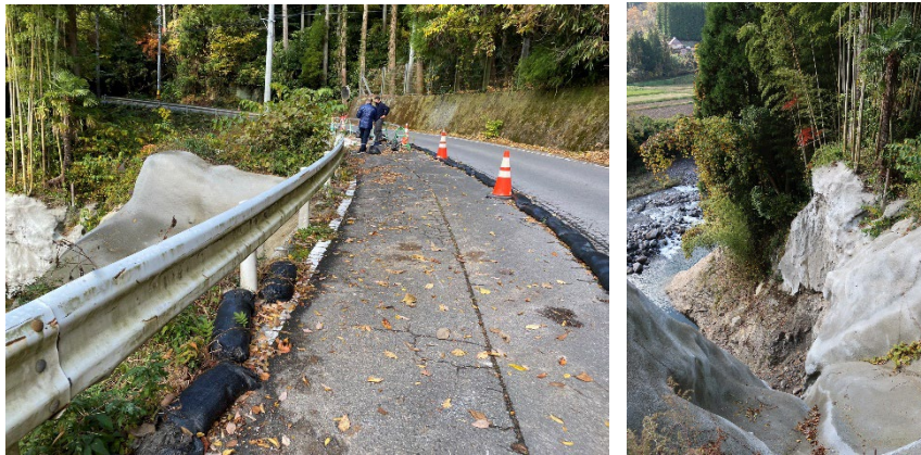
写真-4. 道路復旧が未着手であった被害箇所（令和4年11月14日現地視察時撮影）
