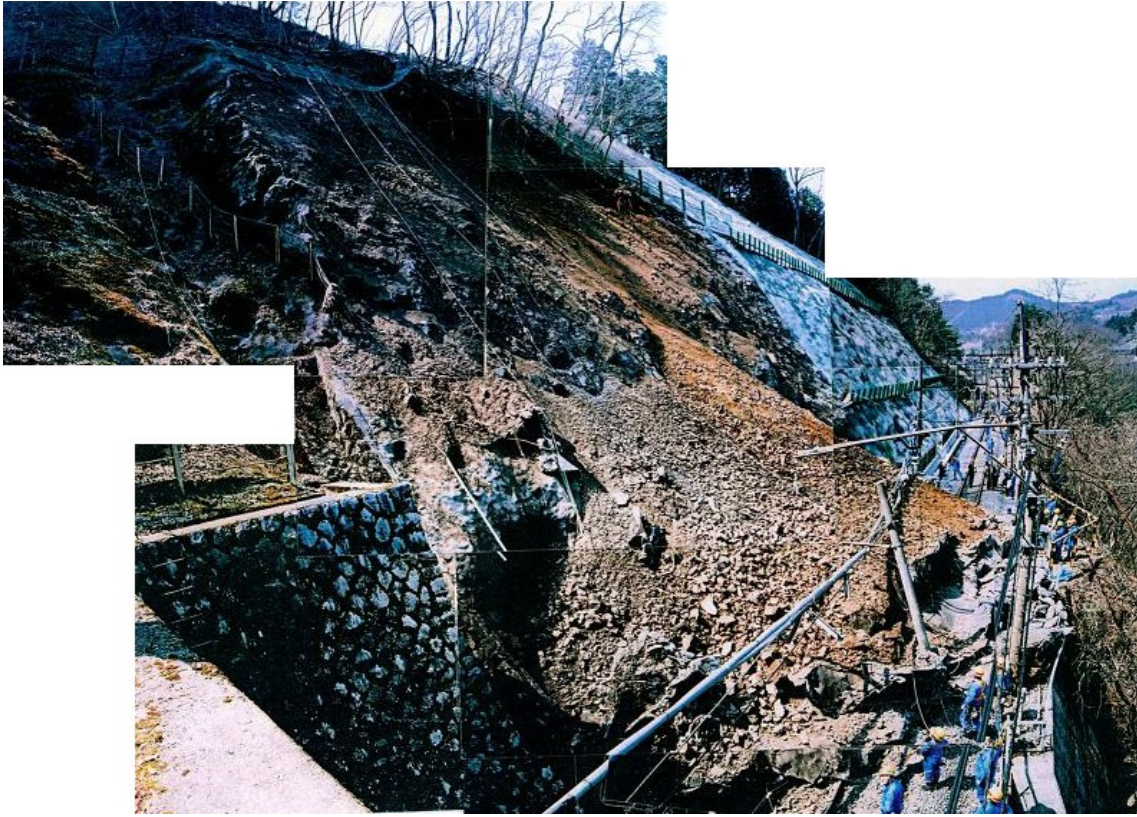
写真1 災害発生現場 1) より
