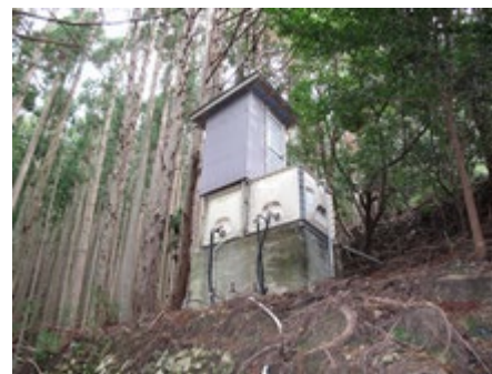
写真4 奈良県十津川村田戸地区飲料水供給施設の塩素注入設備
