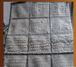
[エアコンフィルター汚れ]
