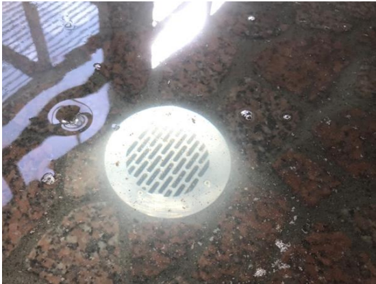
図3 施設Bの洗浄中、循環給湯口から浴槽に汚れが入ってきた様子
