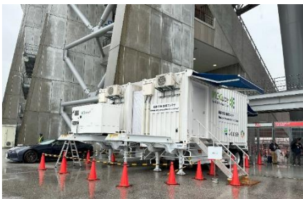
図5 医療コンテナ設置状況
