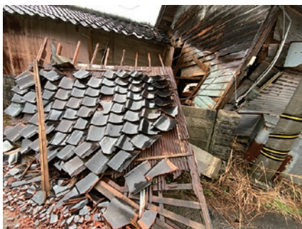
＜写真1＞能登半島地震により被災した地域の状況
