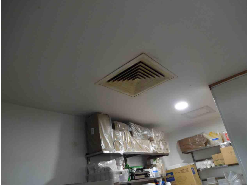
写真4 1：換気扇と天井に隙間ができており虫や鼠族の侵入を防ぐために隙間を塞ぐよう指導。
