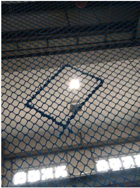
図5 部分的に補修がなされた箇所
