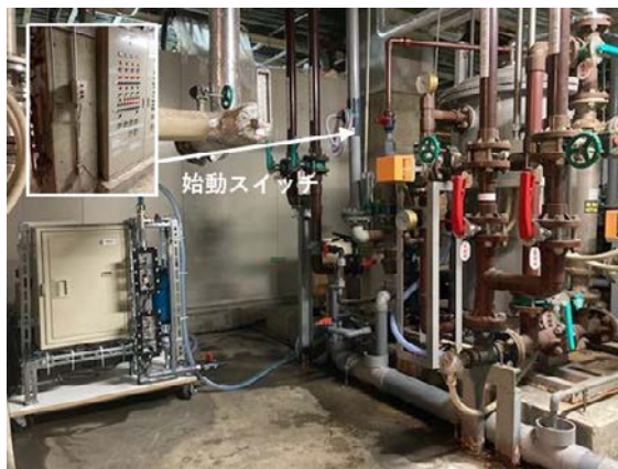
図 13 オゾン供給装置設置状況 (RUN3)
