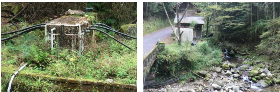
写真 2.2 簡易水道整備前の水道施設の状況 2
