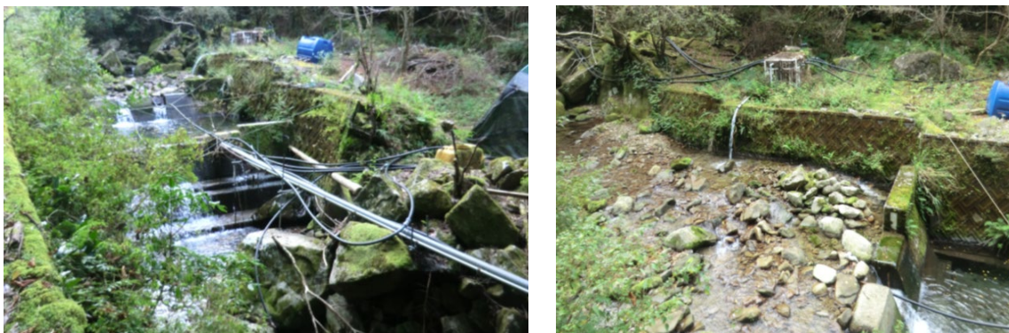
写真 2.1 簡易水道整備前の水道施設の状況 1
