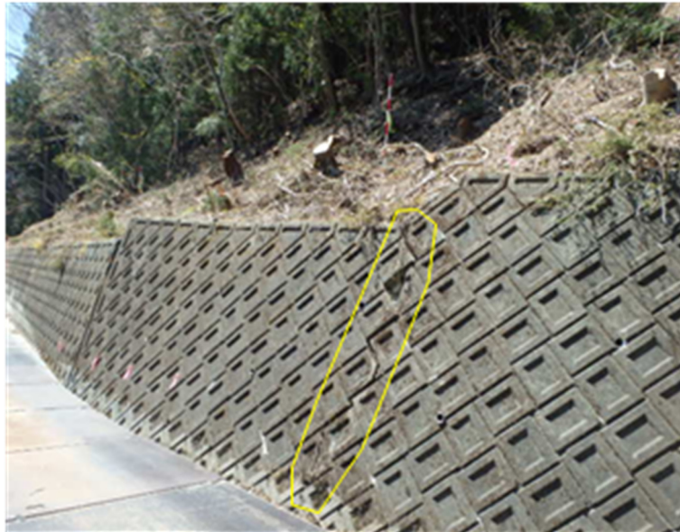
写真-2 地すべり左サイドブロックの開口クラック
