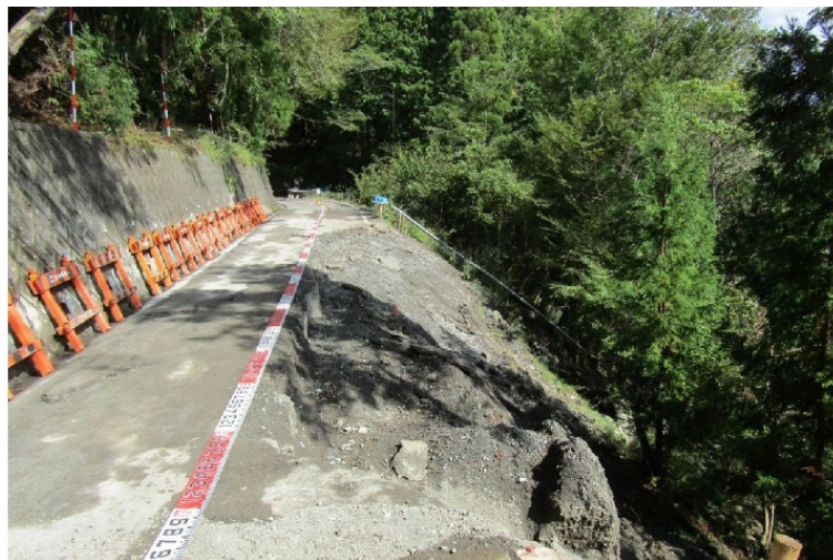
写真-1 被災状況と施工路線
