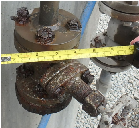
図1 現地調査でのフランジ継手
