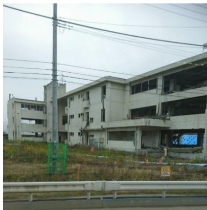
津波被害を受けた市立気仙中学校 (平成 30 年度より市立高田第一中学校に統合)
