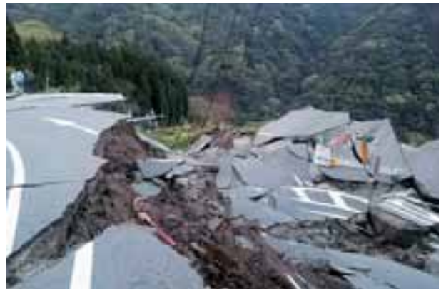
道路の損壊（南阿蘇村）
