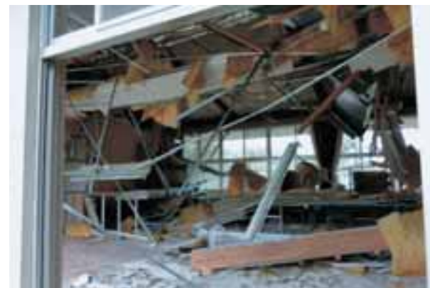
大きな被害を受けた福祉施設（熊本市）
