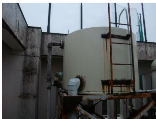
写真 4-3 建築物 B の高架水槽
