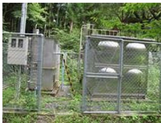
写真1 川上飲料水供給施設 浄水処理施設
