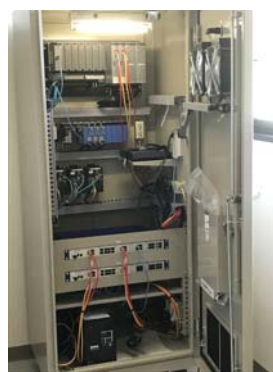
遠隔監視制御盤
