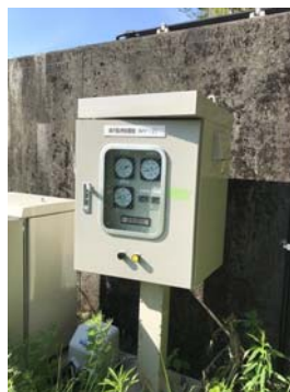
遠隔監視制御盤 (配水池水位、流量)
