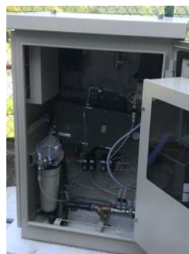
自動水質監視装置
