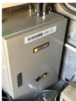
遠方監視装置盤
