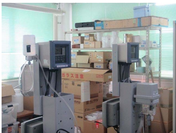
③ 浄水場出口水質計器 (F社、Mw社) : Nd 浄水場
