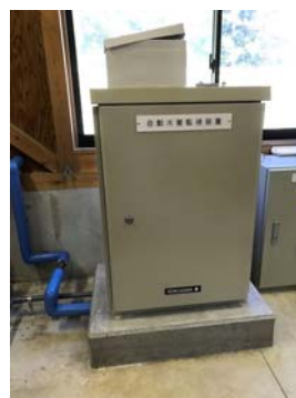
自動水質監視装置
