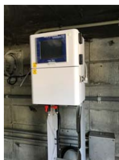
自動水質監視装置
