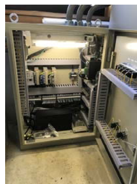
遠隔監視制御盤（内面）
