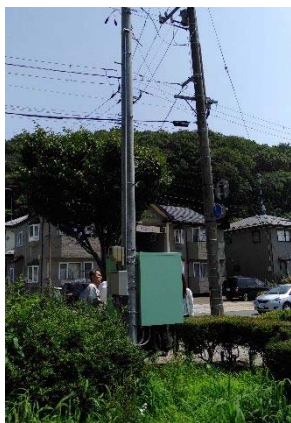
② 遠隔監視装置子局 (Di社) : I市Y地先 ※計器は地下
