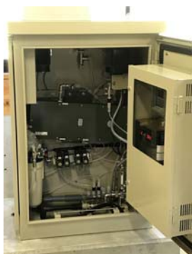
自動水質監視装置
