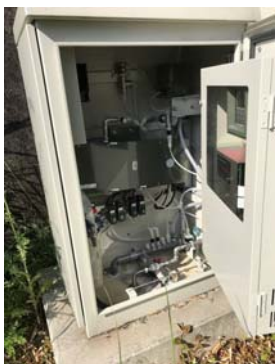
自動水質監視装置
