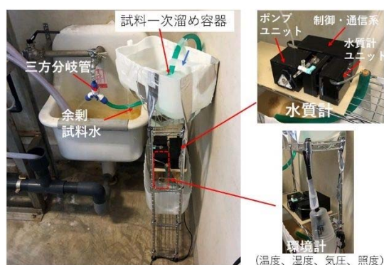
図4 水質計設置状況
