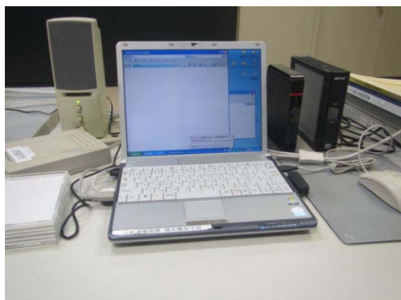
③ 監視モニター (Mt社) : Fg浄水場
