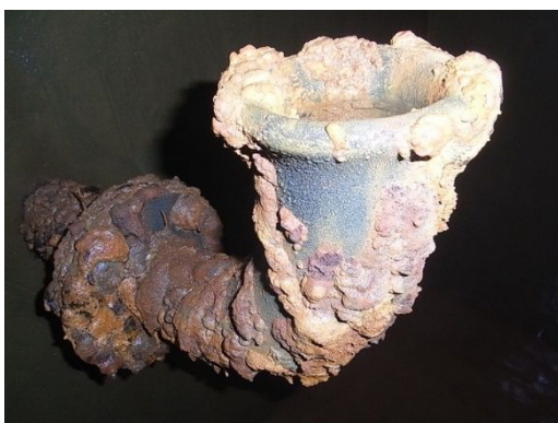
C) A 配水池流入管
