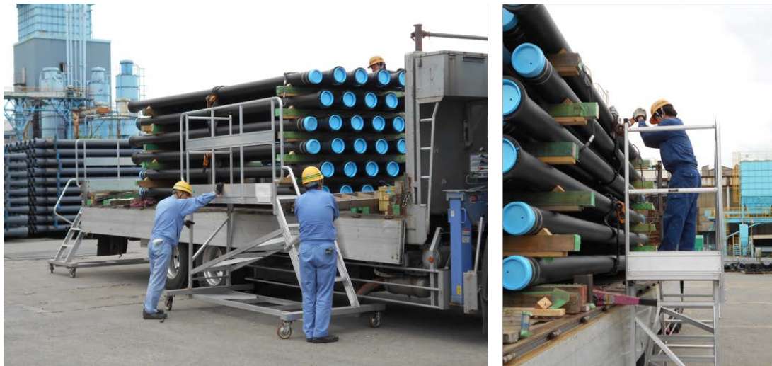
(a) 荷主庭先据置型の墜落防止設備を設置している状況
