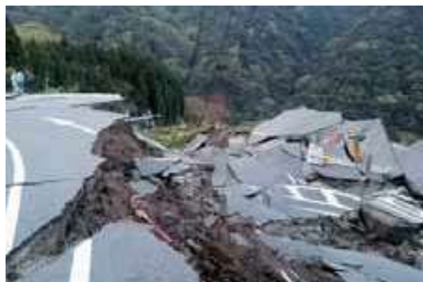
道路の損壊（南阿蘇村）
