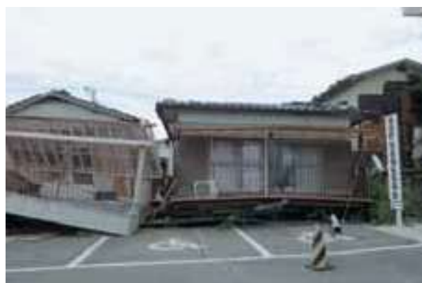
倒壊した家屋（益城町）
