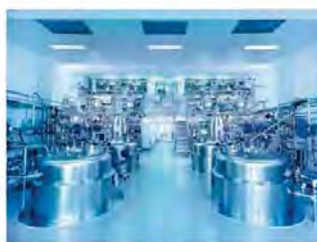
Celltrionのプラント (12,500L × 4基)
