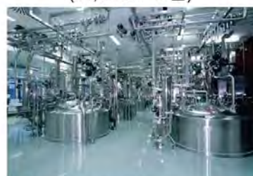
Boehringer Ingelheimのプラント (12,000L × 8基)
