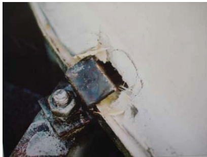
一体型タンクの亀裂
