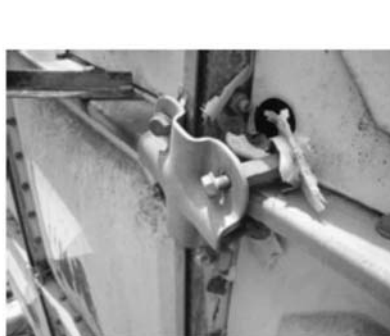
FRP製タンク(108t)。 スロッシング水圧によって、上段側 板パネルが破損。 修理すれば、使用可能。
