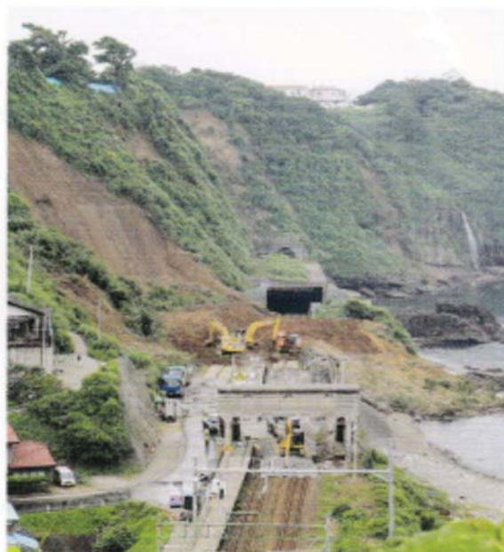
▲ JR信越線 柏崎一穂線間 青森川駅付近で発生した大規模な崖崩れ。復旧作業が進められたが、約2ヶ月後の9月13日に開通した。
