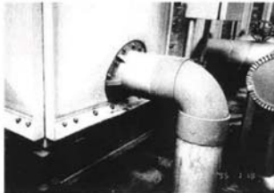
溢水口の破損（サポート無し）
