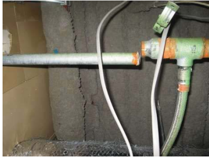
スプリンクラー配管の破損
