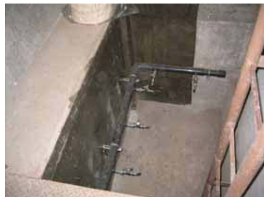
受水槽に非常用取水栓を設置した例
