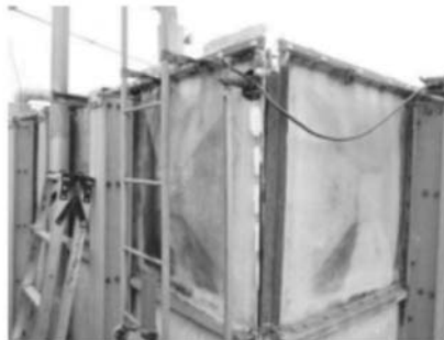
FRP製タンク(150t)。 スロッシング水圧によって、天井パ ネルと上部タンクコーナーが破損。 修理すれば、使用可能。
