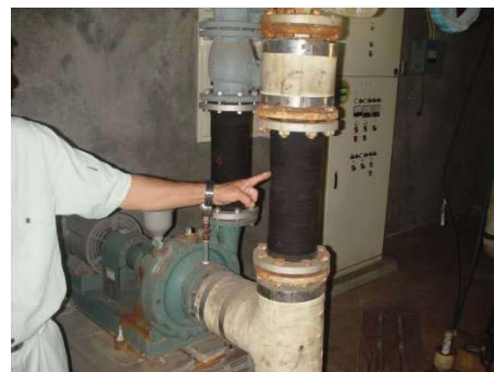
フレキシブルジョイントの亀裂
