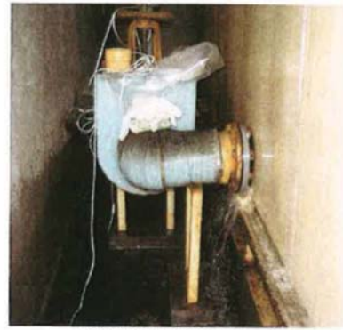
震災被害による漏水の一例
