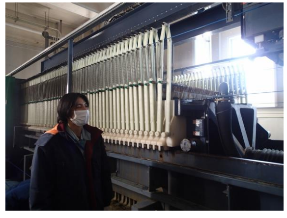
汚泥処理施設③（脱水機：中時間型 8h）
