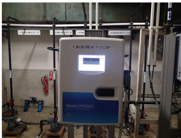
沈澱処理水 TOC 計
