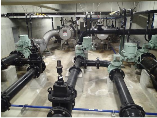
紫外線処理設備（1）
