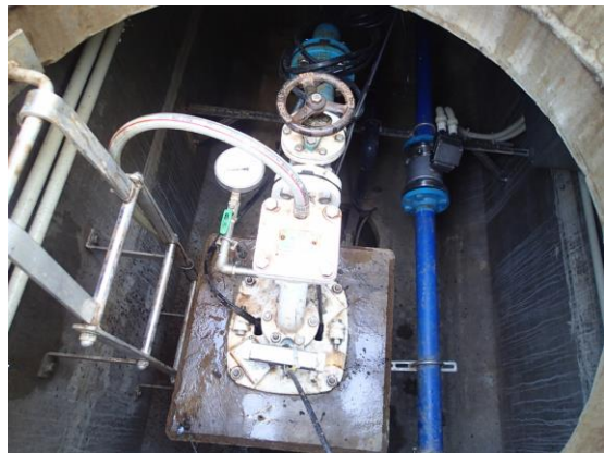
⑨Rd 浄水場（井戸マンホール）
