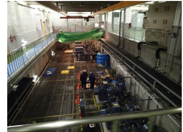
送配水ポンプ
