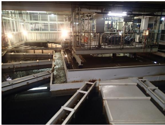
高速凝集沈澱池①
