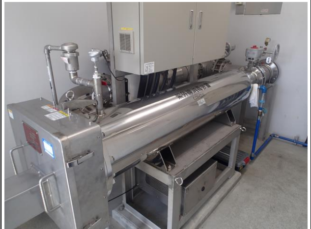
紫外線処理設備（1）
