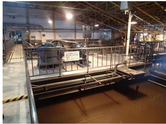
高速凝集沈澱池②
