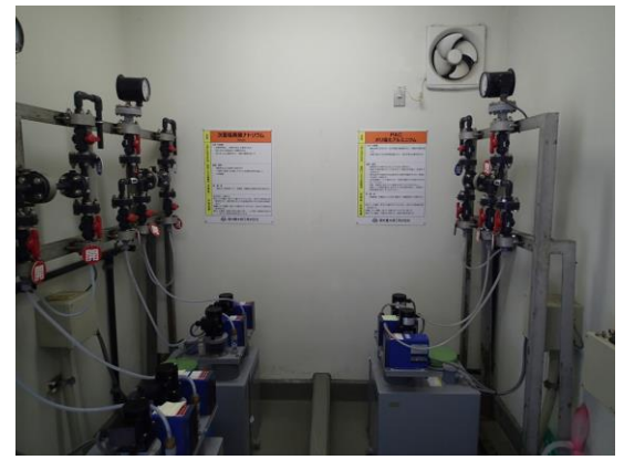
⑩Rd 浄水場（薬注室：PAC 及び次亜）
