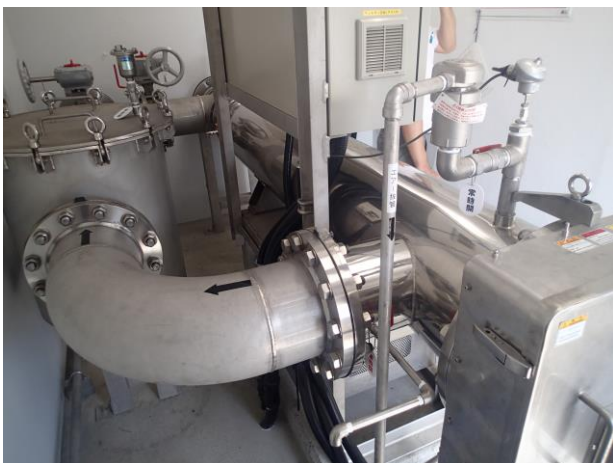
紫外線処理設備（2）
