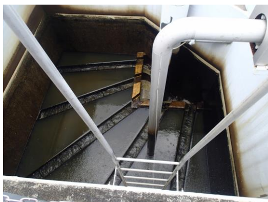
⑤Hh（ろ過池、洗浄中）
