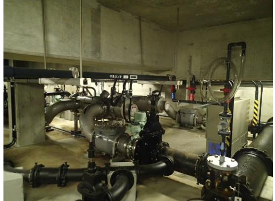
紫外線処理設備（2）
