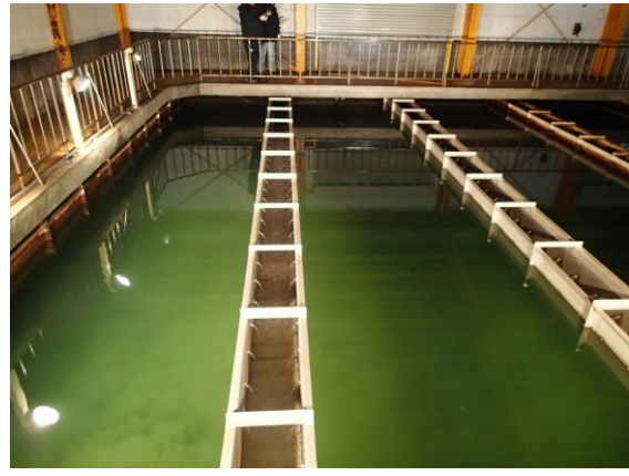
高速凝集沈澱池④（傾斜管なし）
