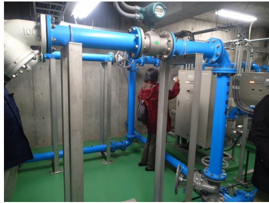
⑭My 水系浄水場-2 (紫外線処理設備)
