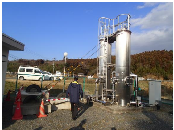
⑧Rd 浄水場（ろ過機）
