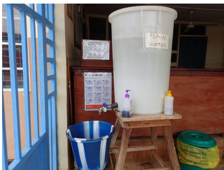
図8 ラッサ熱病棟のスタッフ用手洗い蛇口
