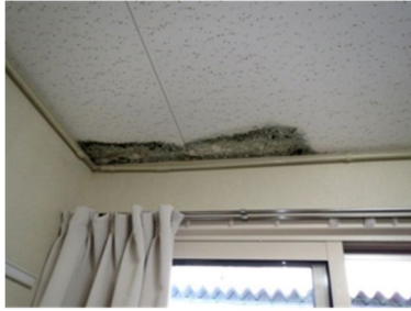
(1)天井パネルのカビ
