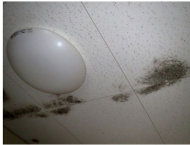
(2)天井パネルのカビ
