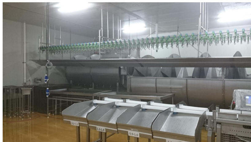
写真2-5 チラー槽およびと体解体室
