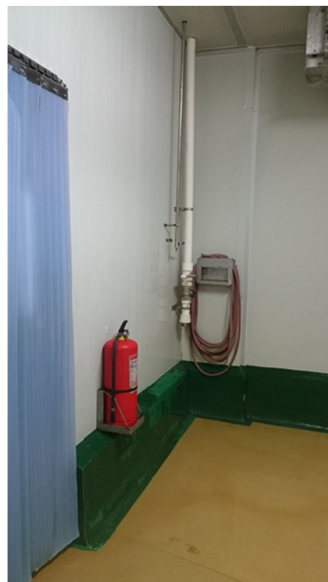
写真2-8 ホースラックに巻かれた ホース、床と壁の接触場所はR構造、 床は緩やかな傾斜で水たまりはない
