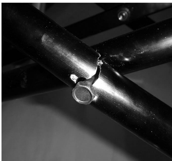
図4. クロスパイプ破損の様子
