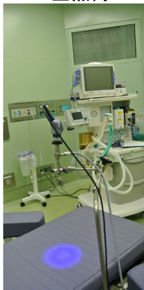
天井灯 全点灯
