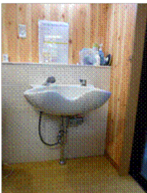
写真5 脱衣室に設置された洗髪洗面器
