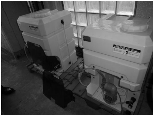
図 16 二段凝集処理設備の設置事例
