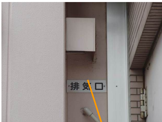
屋外放出口の設置場所
