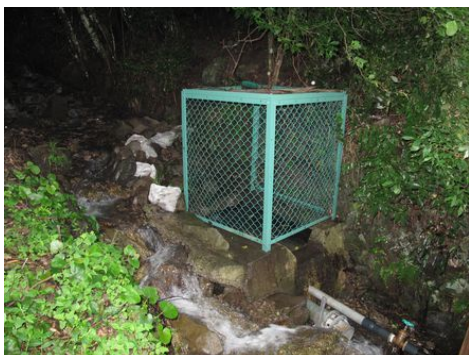
写真 7 権現沢水道組合 取水施設
