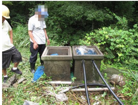
写真5 山根組水道組合 浄水処理施設
