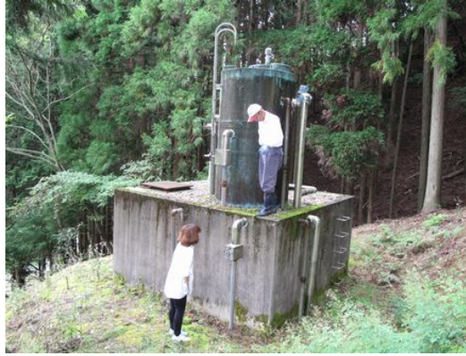
写真 11 上向流式緩速ろ過装置と配水池（浄水槽）
