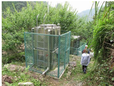
写真 8 沈砂池と配水池
