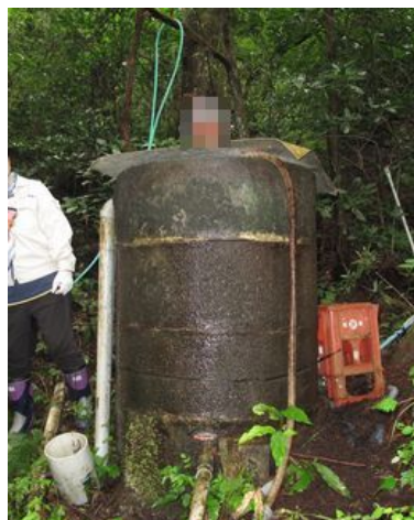
写真3 富厚里中組山水会 沈砂池
