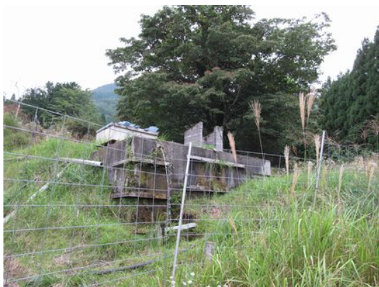
写真12 貯水槽（配水池）
