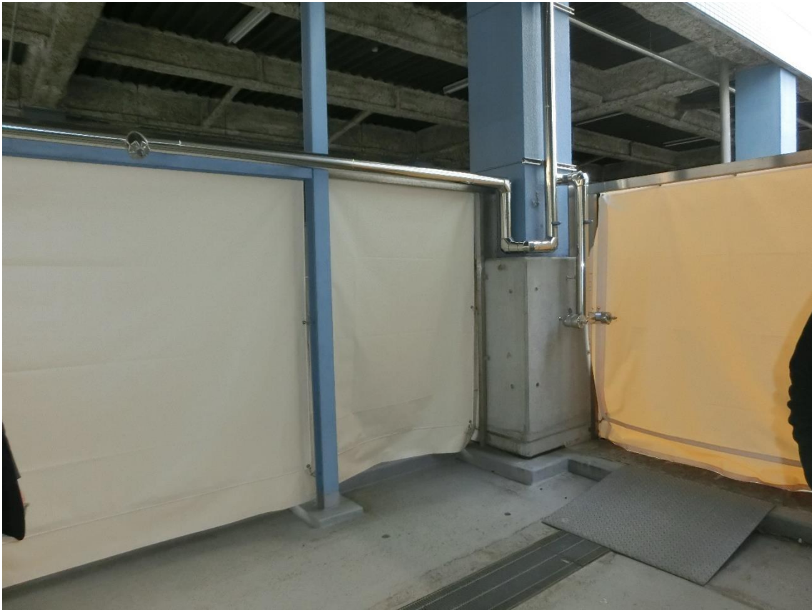
11. 常設屋外除染設備（G）
