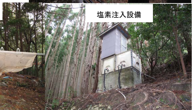
写真 3 田戸地区飲料水供給施設 浄水施設
