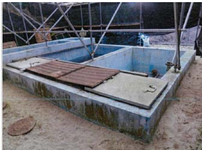
写真 1 I 飲料水供給施設の緩速ろ過池 1)
